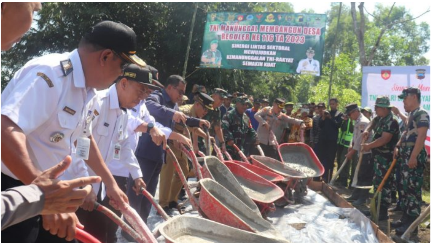
Peletakan Batu Pertama Sebagai Simbolis Pengerjaan Jalan TMMD Reguler ke-116 Kodim 0709/Kebumen di Desa Pejengkolan, Kecamatan Padureso, Kabupaten Kebumen, Jawa Tengah
